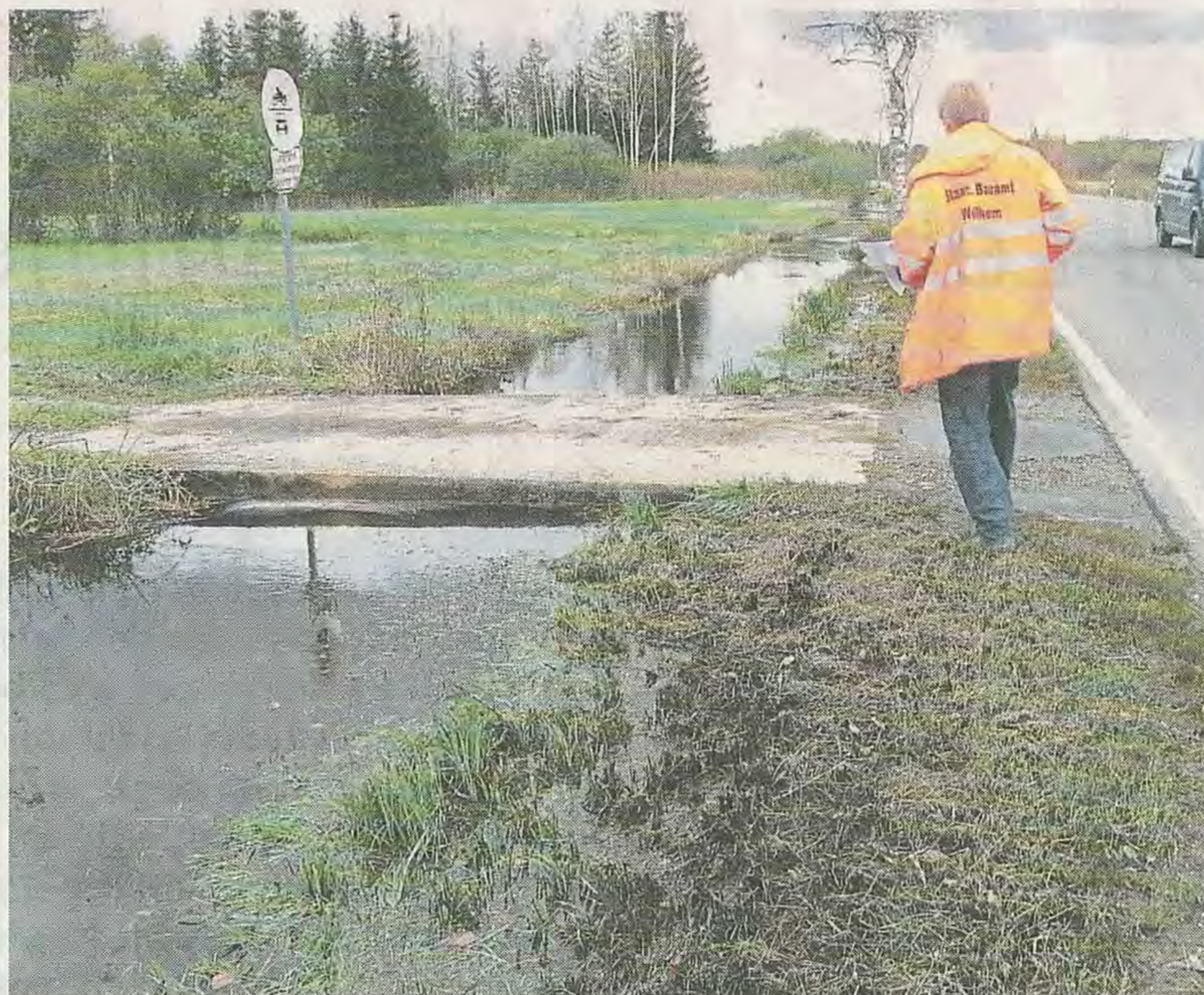
Randvoll: der Problem-Graben im Westen der B2. Das Wasser steht bis zur Oberkante. Bei Regen kommt es oft zu Überflutungen. FOTO: WWA
