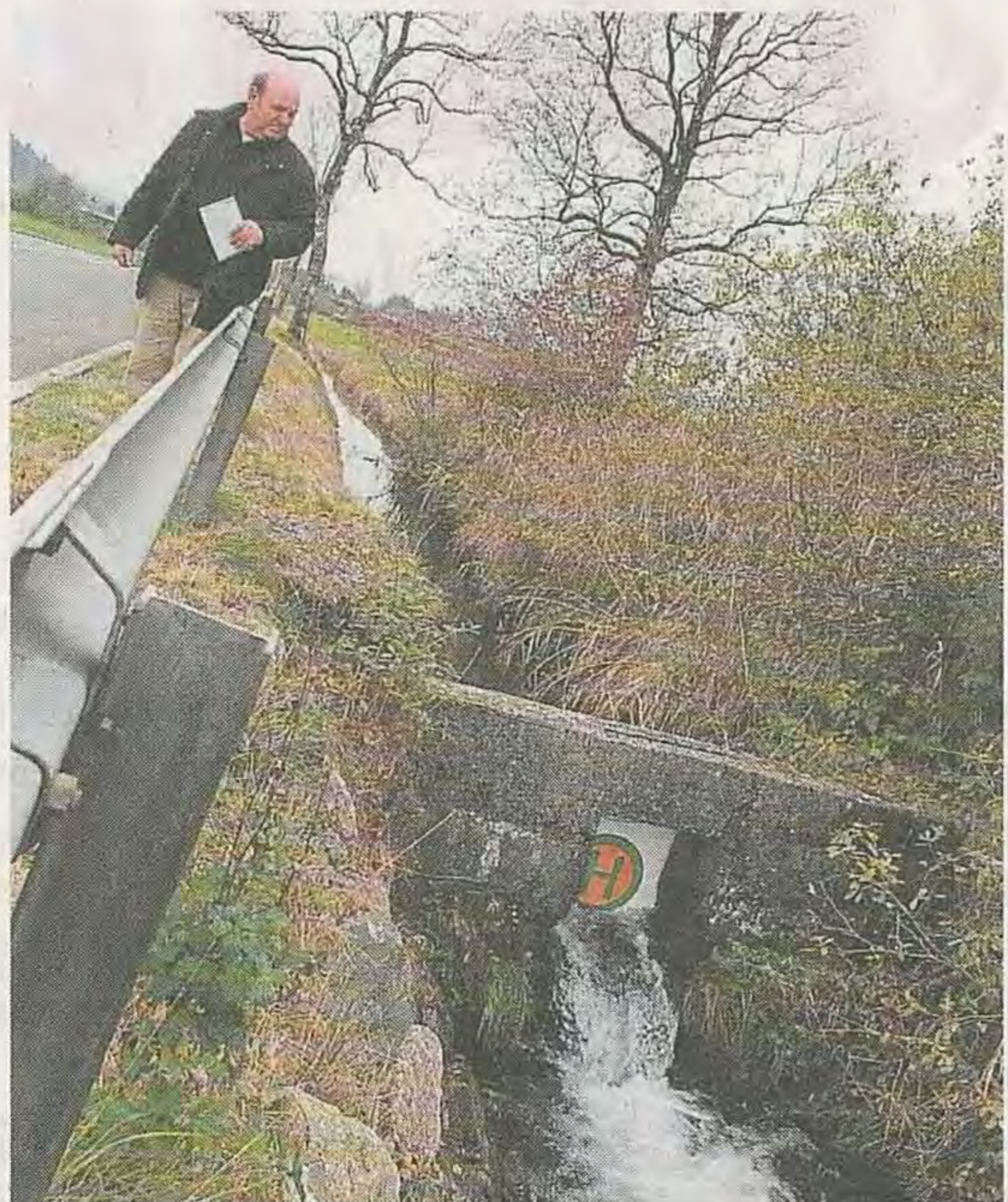
Provisorium: Ein Schild bremst im westlichen Graben das Wasser im Wehr (l. Albert Kern). F.: SJ
